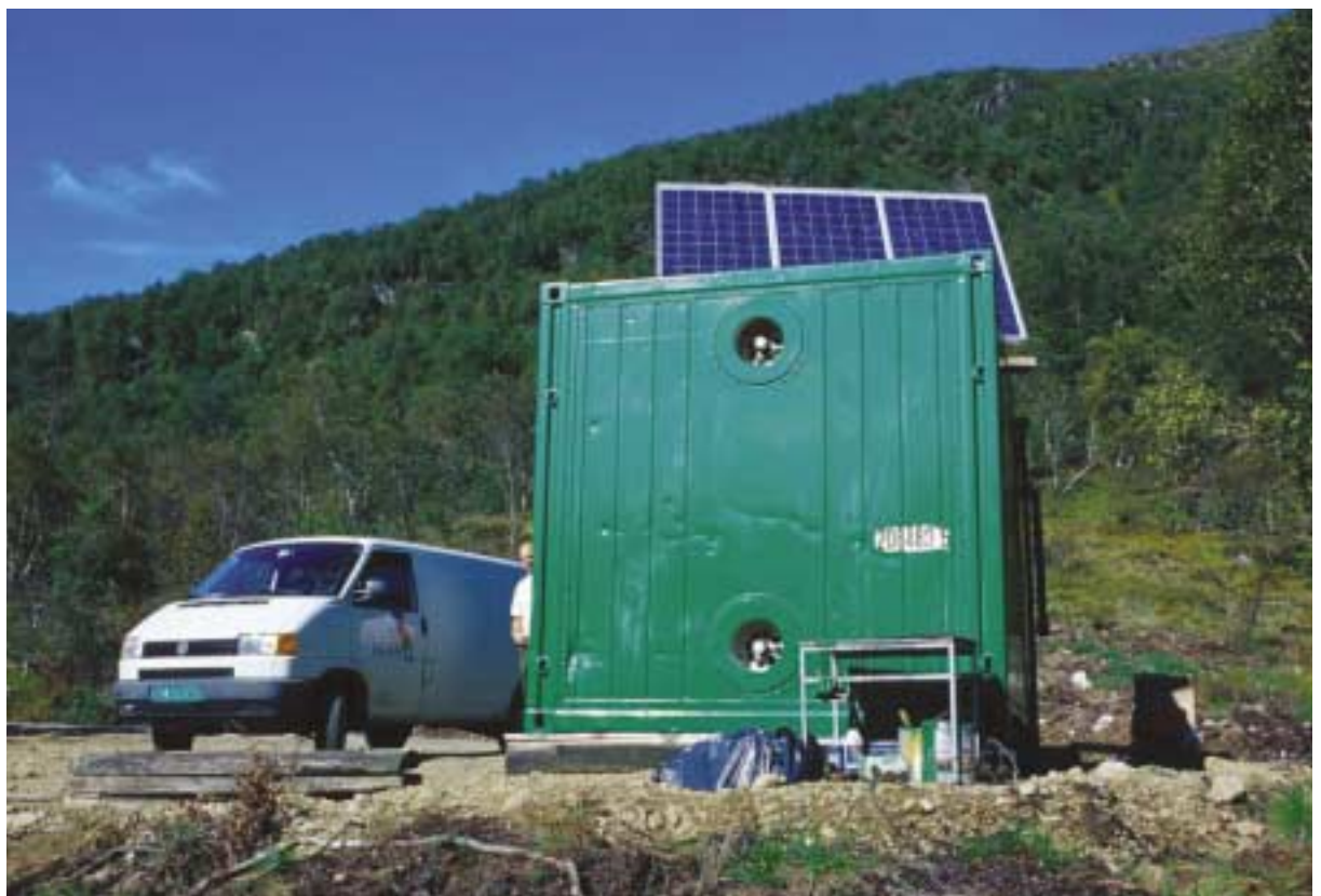
Figur 4. Doseringsanlegget som ble brukt til dosering av aluminium til Batnfjordselva. Containeren inneholder en tank (12 m 3 ) for sur Al-løsning, en doseringspumpe og en styringsenhet. Anlegget gikk på solceller fordi det ikke var tilgang på strøm ved doseringspunktet. Styringsenheten er koplet til en vannstandsmåler i elva som er kalibrert mot vannføringsmålinger utført på ulike vannstander. Anlegget har også mobiloverføring som muliggjør kontinuerlig overvåking av doseringsmengder og mengde gjenværende Al-løsning. Foto: R. A. Pettersen
